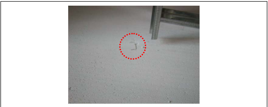
○ 図7 壁面に残る野縁受けの衝突跡
